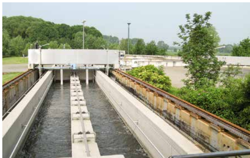
Belüfteter Langsandfang der Kläranlage Zörbig
